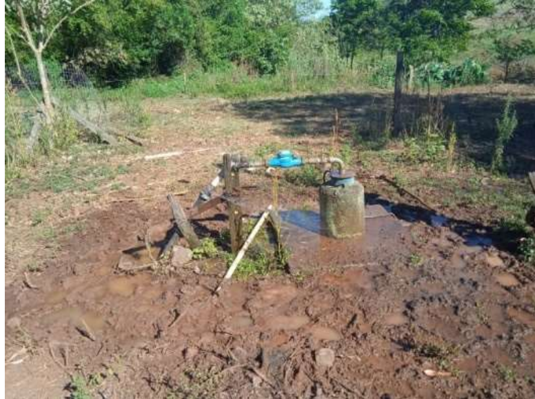
Figura 40: Poço artesiano da Linha Formosa.
