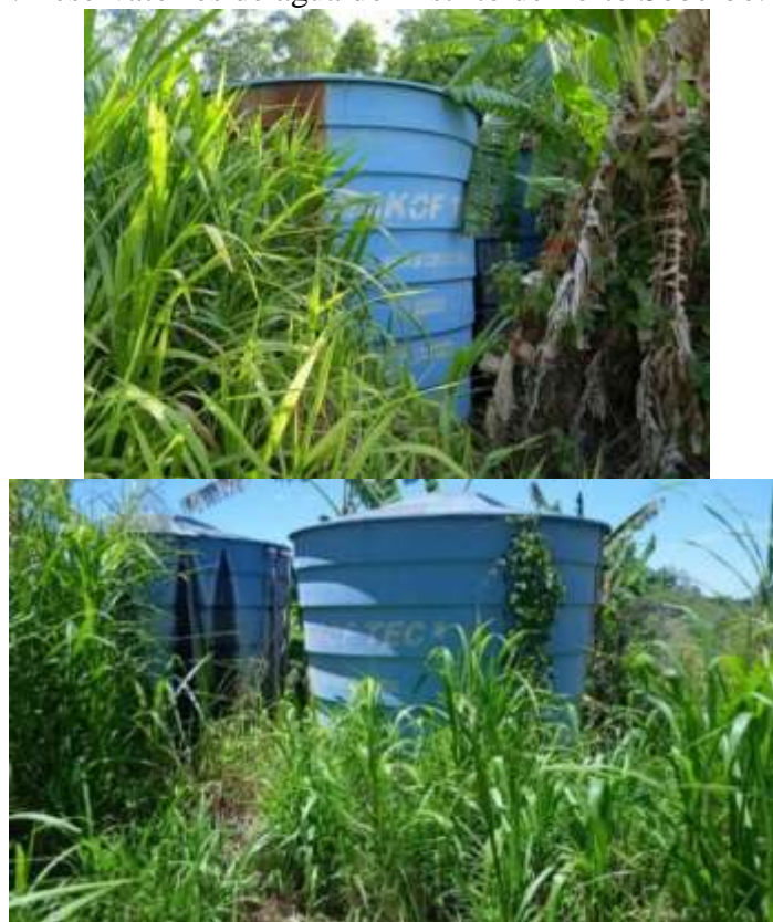
Figura 51: Reservatórios de água do Distrito de Porto Soberbo.
