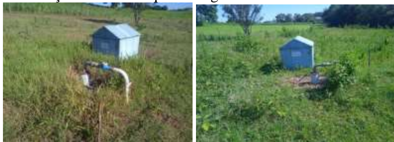
Figura 36: Poço artesiano Esquina Progresso.
