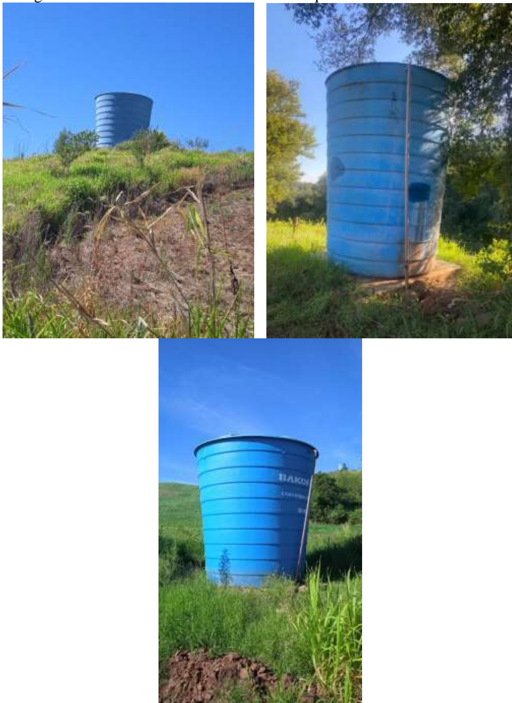
Figura 39: Reservatórios da localidade de Esquina Salãozinho.
