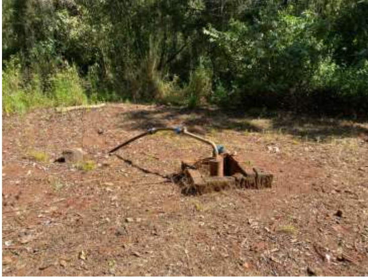
Figura 29: Poço artesiano Distrito Alto Uruguai.
